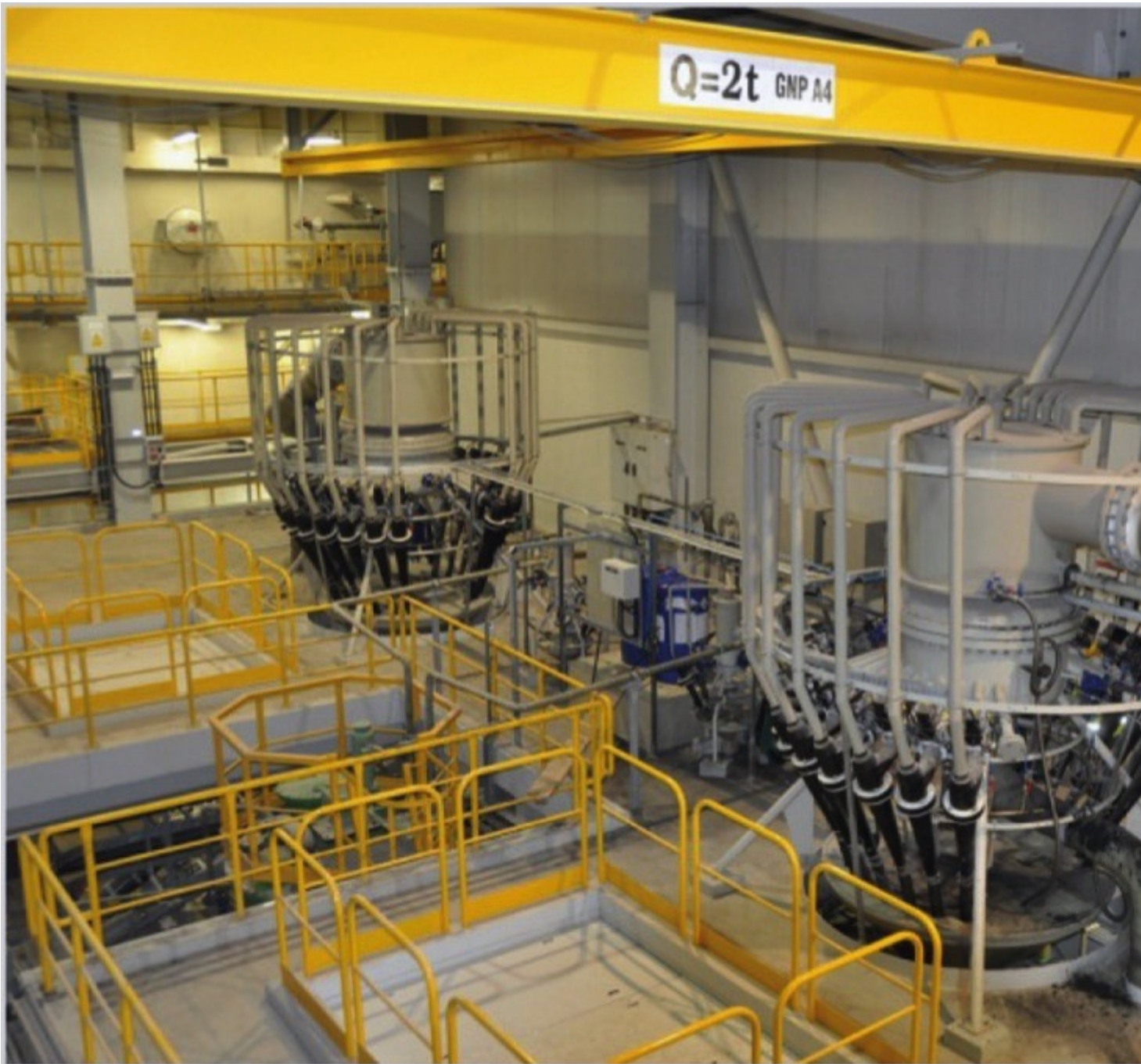
FGD gypsum dewatering system in Belchatov, Poland. (Picture: © thyssenkrupp Fördertechnik)
