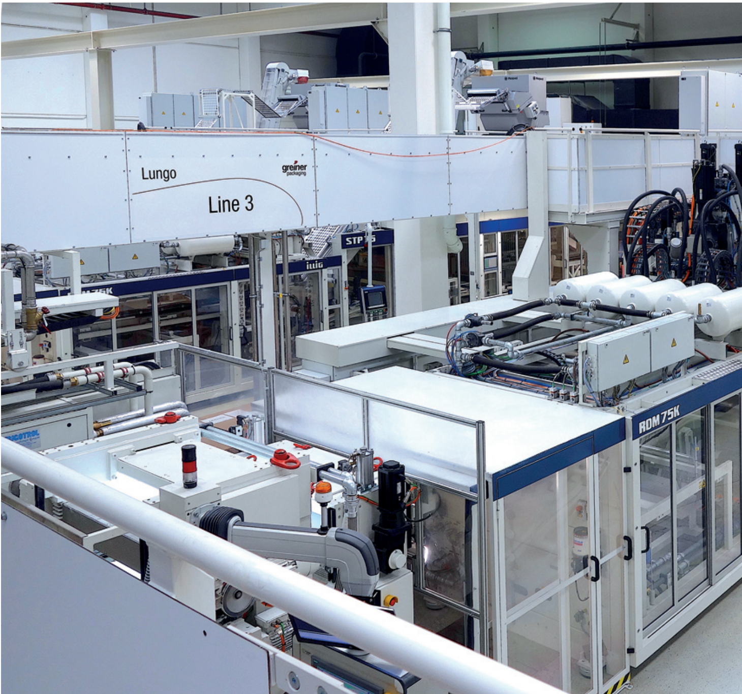
Abb.2: Die aus der Extrusionsanlage kommende 7-Schicht-Barrierefolie läuft direkt in eine Multikavitäten-Tiefzieh- und Stanzanlage. Das zurückbleibende Stanzgitter und allfällig anfallende Schlechttteile werden direkt anschließend einer Schneidmühle zugeleitet (im Hintergrund am Maschinenende) und von dort wieder in die Produktion zurückgeführt
