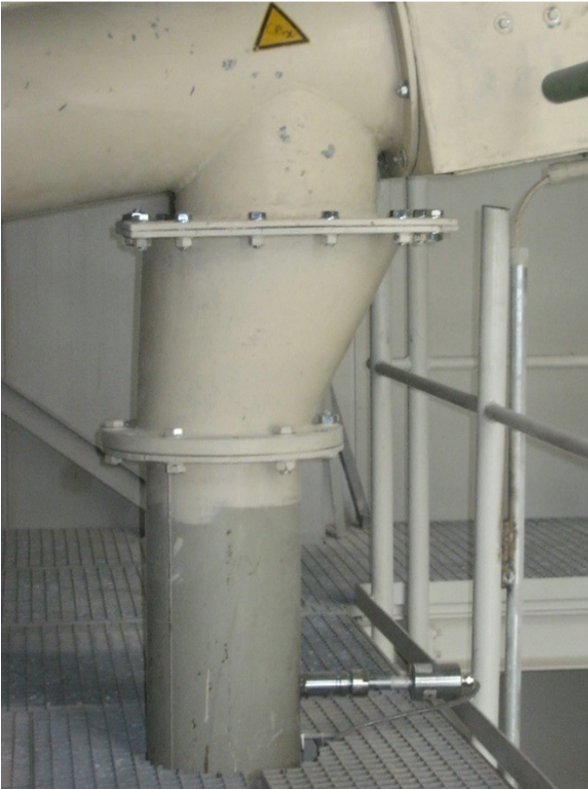
Abb. 2: SolidFlow 2.0 – Mengenmessung von Brandkalk in einem Kalkwerk
