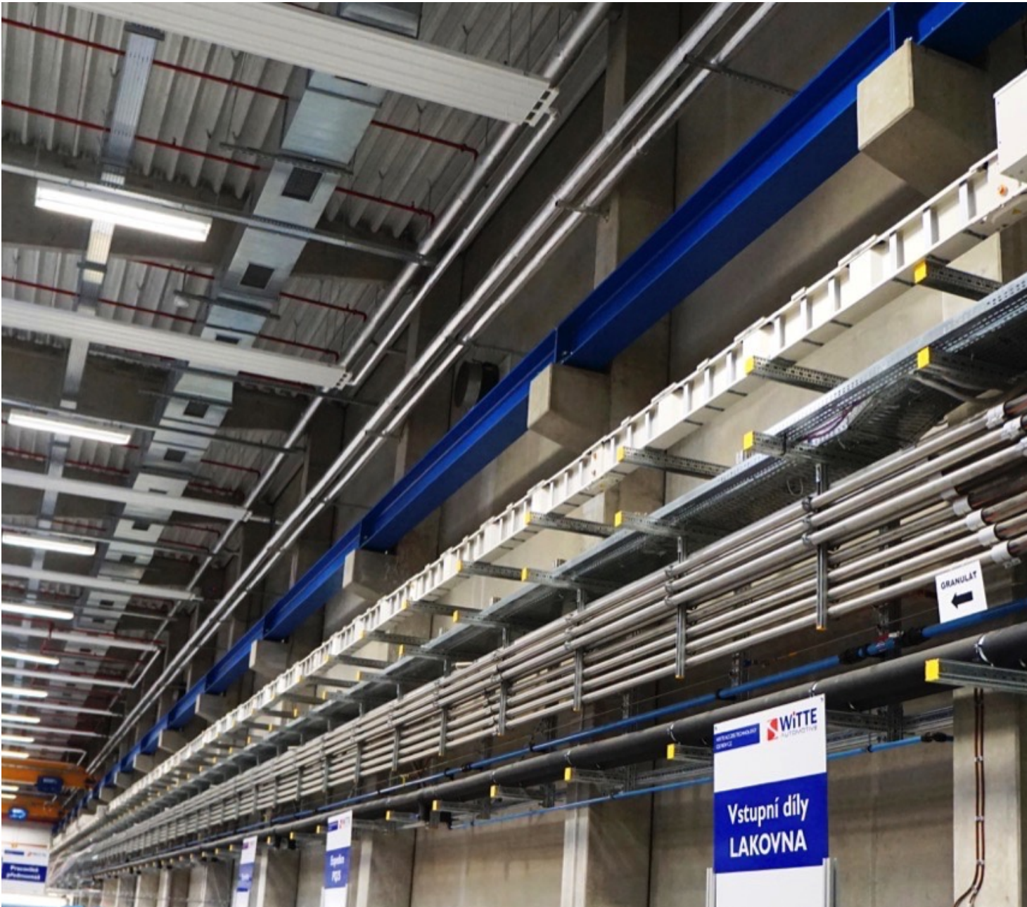
Abb. 7: Die Materialleitung zwischen Trocknungsanlage und den Spritzgießmaschinen, bestehend aus Edelstahlrohren und Glas-Rohrbögen. (Foto: Reinhard Bauer)
